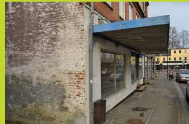
En del ejendomme omkring Bredgade og Søndergade trænger til bygningsfornyelse.
